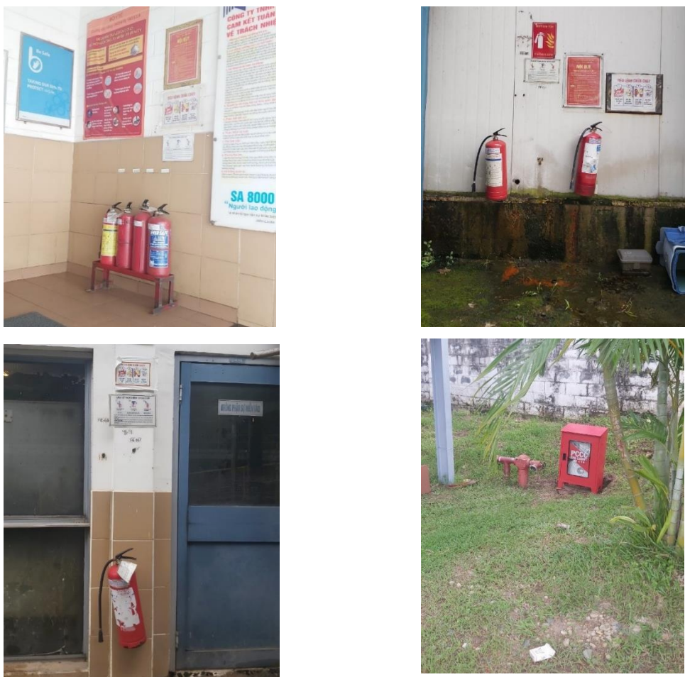
Hình 3.10. Trang thiết bị Phòng cháy chữa cháy
